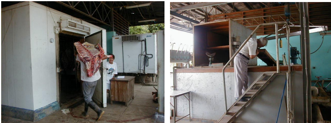
Cámara frigorífica de 10 t de capacidad y planta de hielo de FONDEPES
