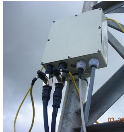
Caja de equipos de comunicación
